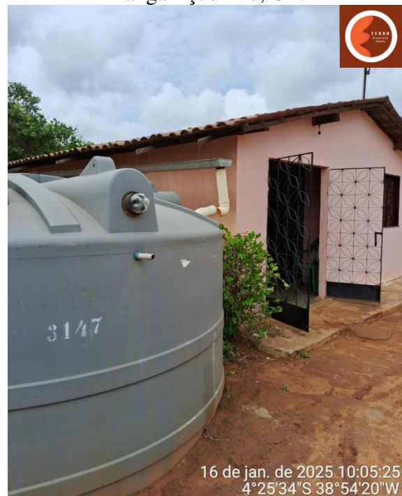
Figura 6 - Cisterna de PVC presente no PE Manga Açudinho, CE.
