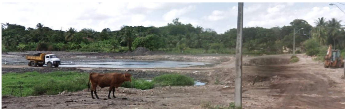
Figura 18 – Obra de contenção do riacho Alagadiço no Campus do Pici.
