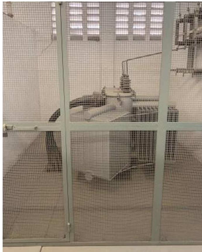
Figura 27 - Trafo de 300KVA- Trafo 02
