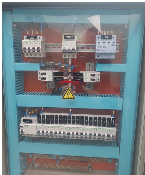
Figura 3 - Quadro de Distribuição
