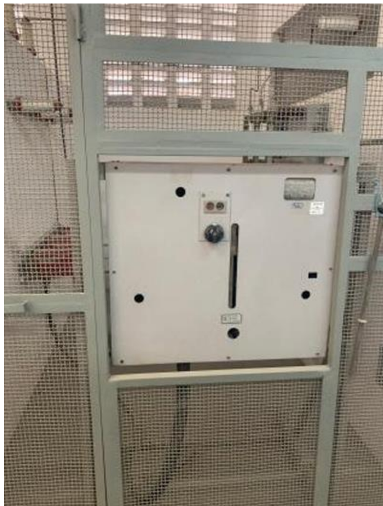
Figura 29 - Disjuntor de Média
