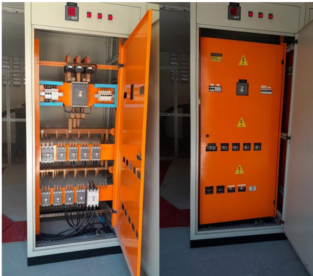
Figura 32 - Quadro de Distribuição do HGCCO
