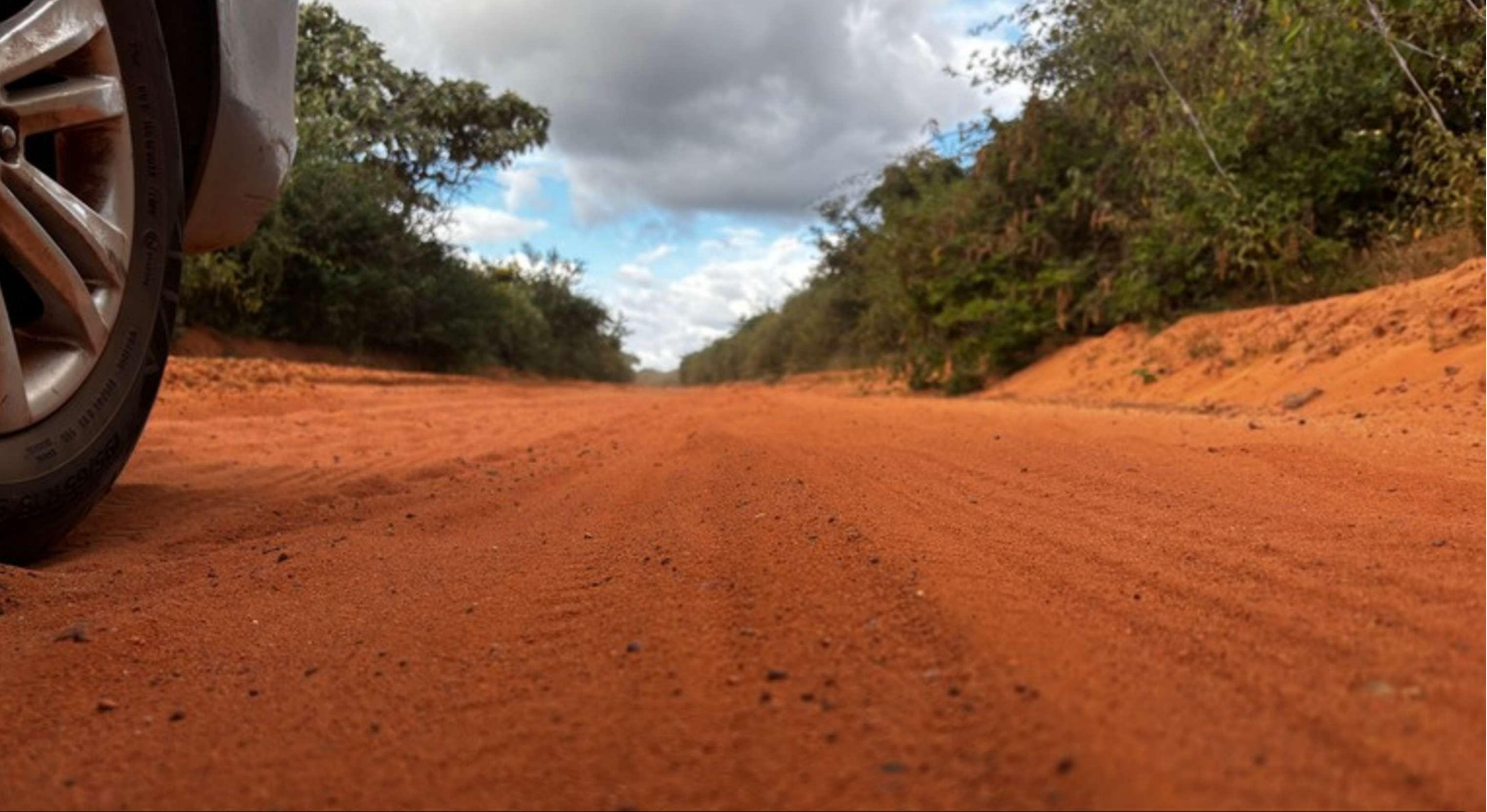
Começo da estrada não pavimentada que liga a zona rural de Pindoba e o município sede de Ibiapina.
