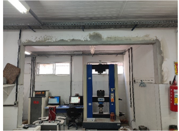
Figura 8 - Parede Com Ausência de Pintura na Área Rebocada
