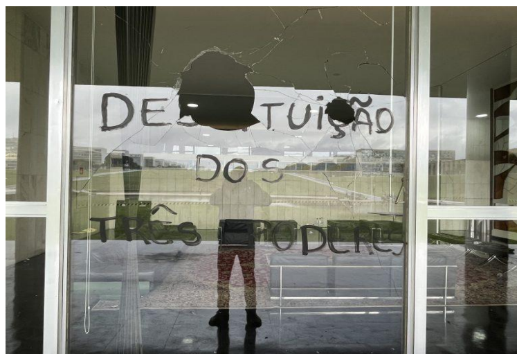
Frase pichada no vidro quebrado do Salão Negro: “Destituição dos Três Poderes”. (Fonte: Rodrigo Bittar/Câmara dos Deputados/Carta Capital)
