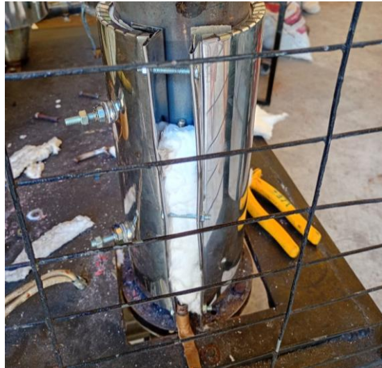
Figura 15 - Termopar tipo K em contato com a parede do reator.
