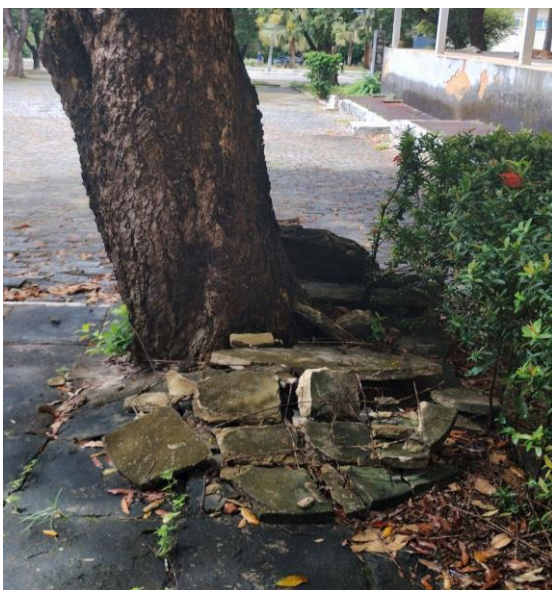
Figura 14 - Árvore causando danos na calçada
