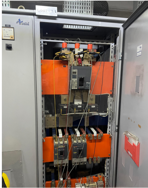
Figura 12 – Medição realizada no barramento do QGBT 1.1
