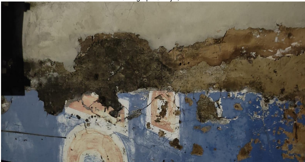
Figura 6 – Rachadura de paredes, tintas, cimento, areia em decomposição, o tempo sendo alarmado na rua 18 do grupo Garajal, ano 2024.
