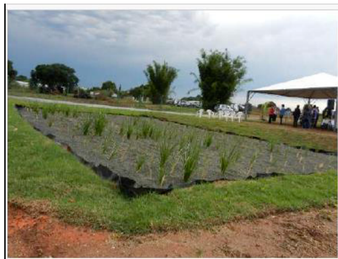
Figura 06 - SAC com fluxo vertical e impermeabilização feita por manta de PVC em Holambra/SP.
