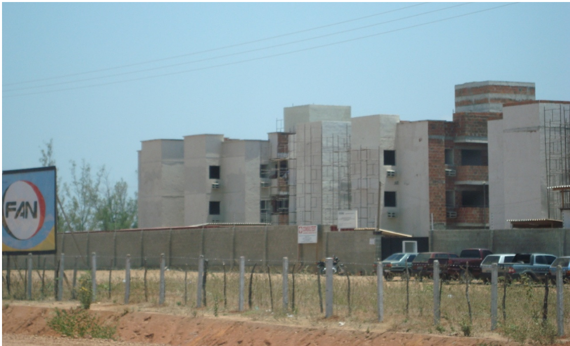
(Fig. 27 - Condomínio Otávio Ferreira, em andamento, prevendo 62 blocos de 3 andares, totalizando 744 apartamentos. Fonte: Foto do autor, 2010.)
