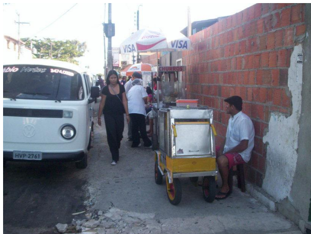
Fig. 78 – Vista de passeio com acessibilidade deficiente tanto pela degradação quanto pela ocupação irregular. Fonte: Acervo.
