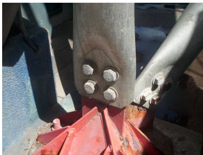
Fig. 180 – Vista em detalhe da chegada da estrutura metálica da cobertura a uma peça de espera fixada ao pilar. Fonte: Edifício da AABB Fortaleza.
