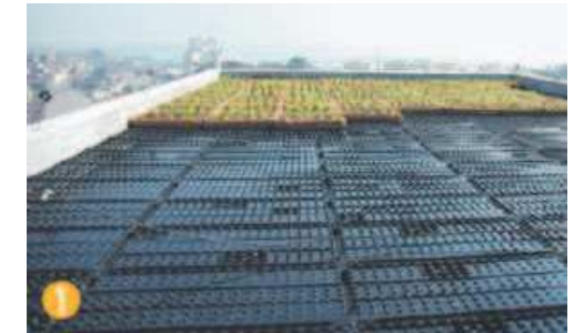
Grelhas de drenagem.
