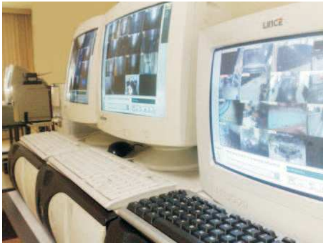
Foto 26 - Vigilância perimetral com acompanhamento de câmaras de monitoramento.
