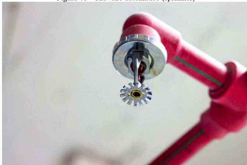
Figura 41 - Chuveiro automático (sprinkler)
