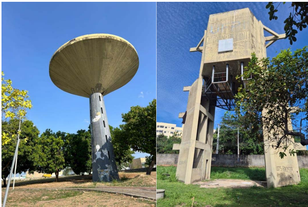
Figura 36- Reservatórios das redes CT-CCHL (esquerda) e CCN-CCS (direita) na UFPI
