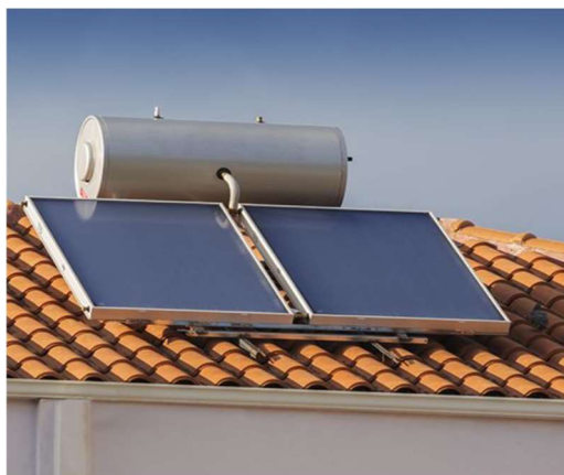
Figura 5 - Sistema de aquecimento por energia solar térmica
