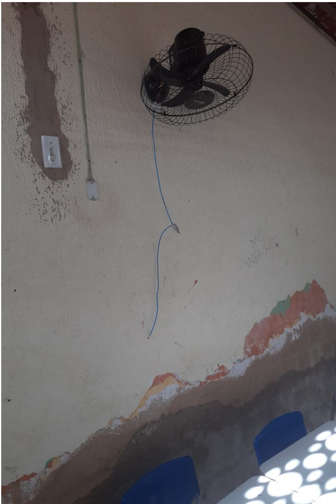
Figura 2 – Precariedade em imagens
