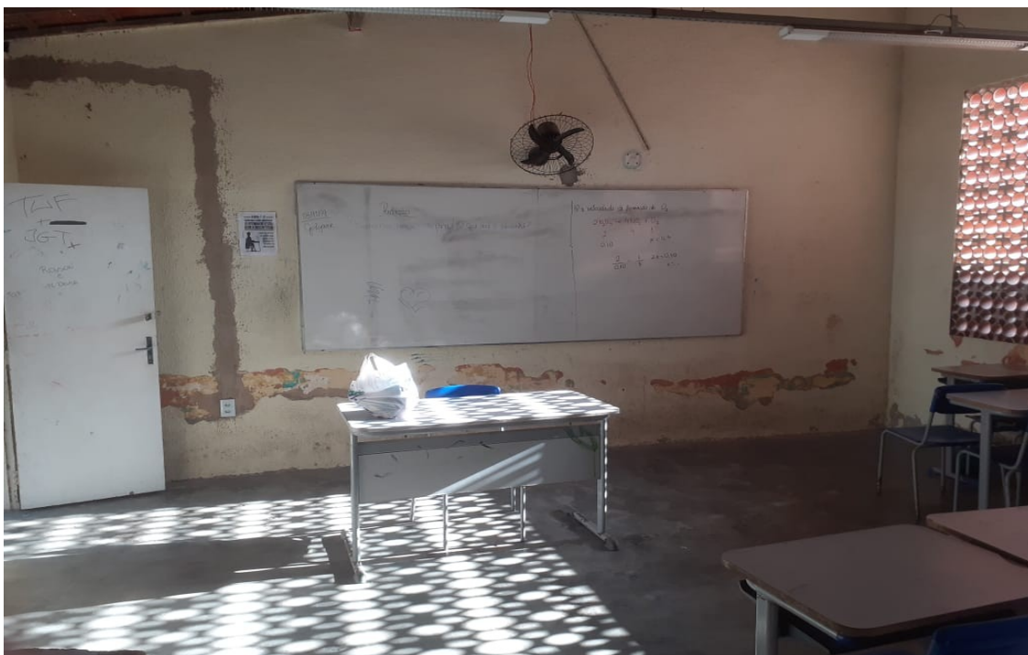
Figura 7 – Precariedade em imagens
