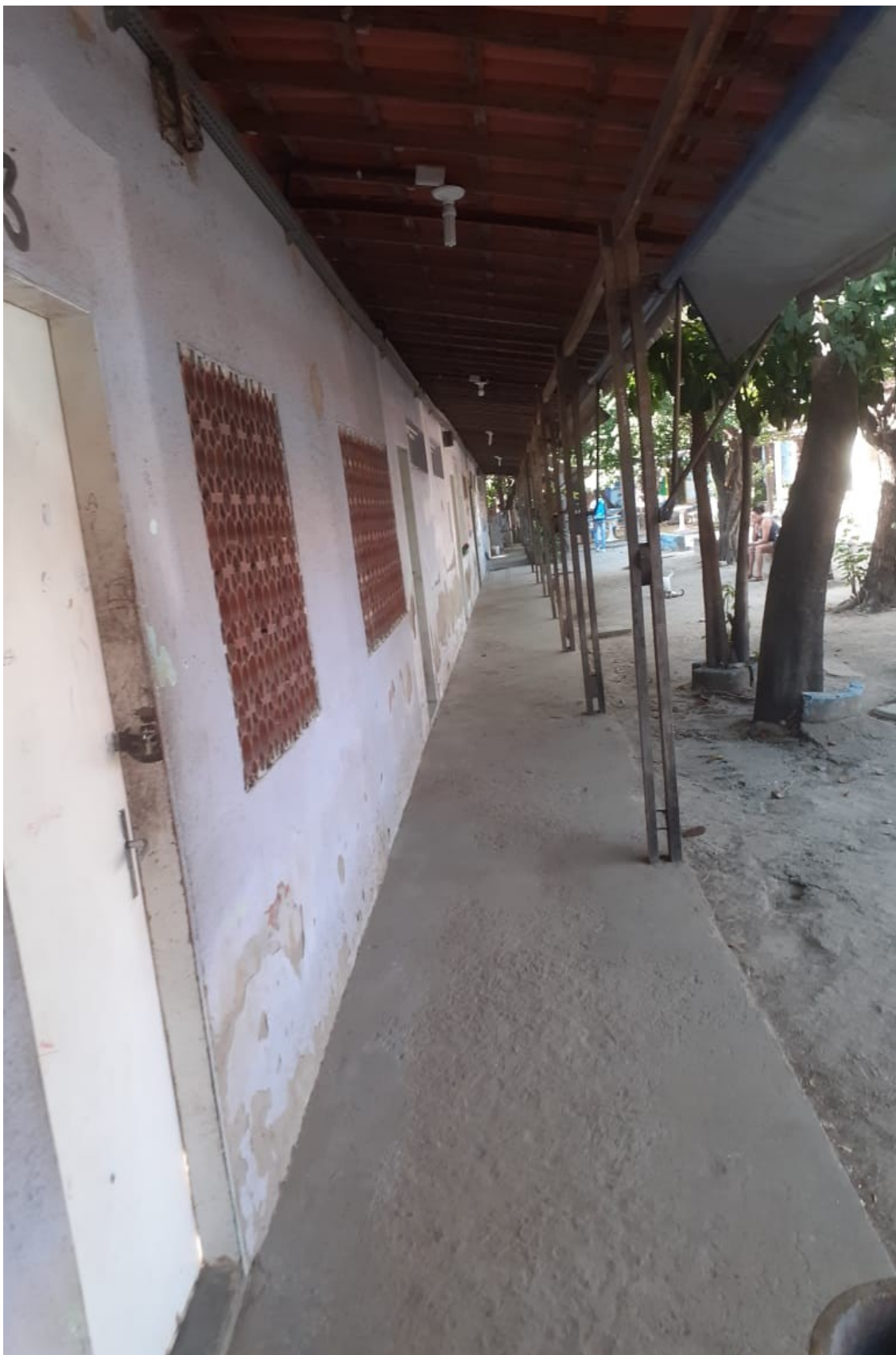
Figura 4 – Precariedade em imagens
