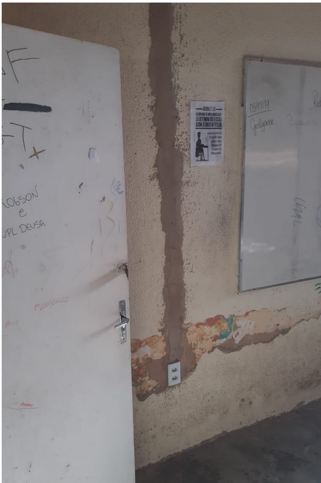
Figura 6 – Precariedade em imagens
