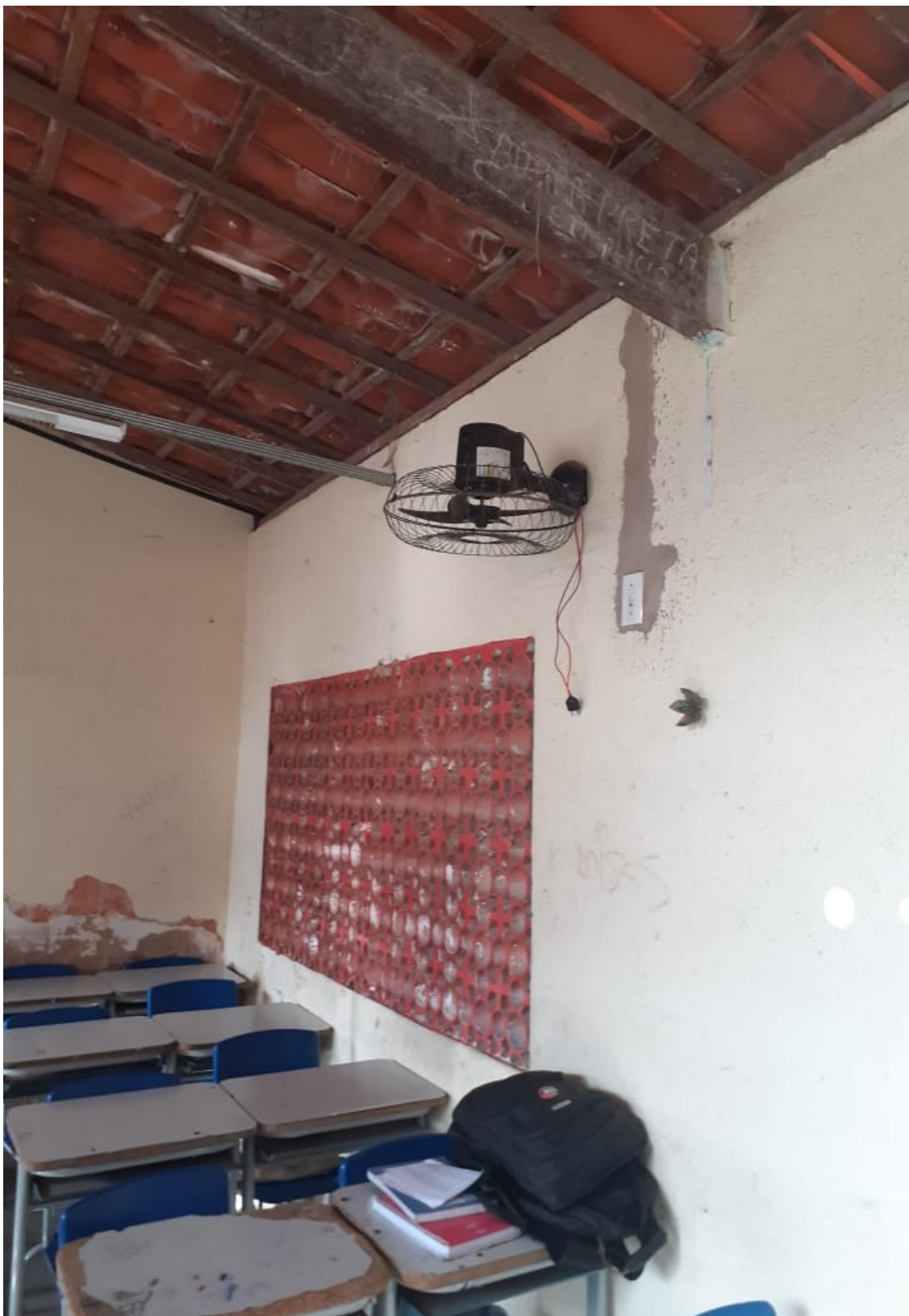
Figura 1 – Precariedade em imagens
