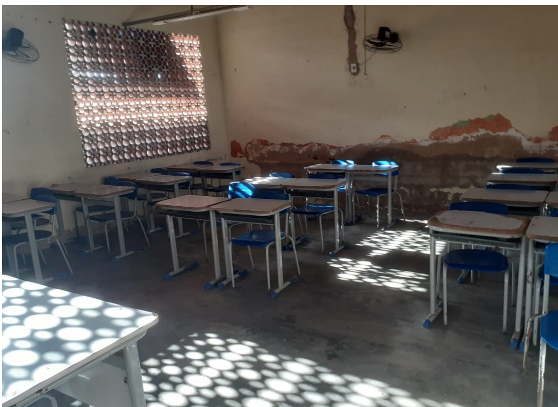
Figura 8 – Precariedade em imagens
