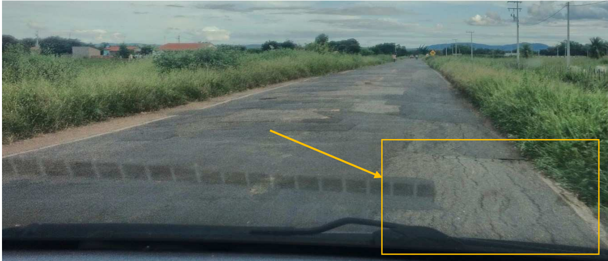
Figura 6 – Desagregação longitudinal e remendos na CE-152, trecho Mauriti-Palestina, Ceará
