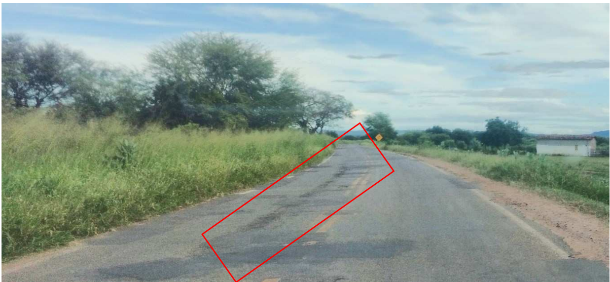
Figura 5 – Perda de agregados na CE-152, trecho Mauriti-Palestina, Ceará
