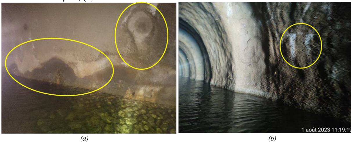
Figura 2.10 – Registros fotográficos realizados na inspeção: (a) Manchas de umidade/infiltrações; (b) Eflorescências.
