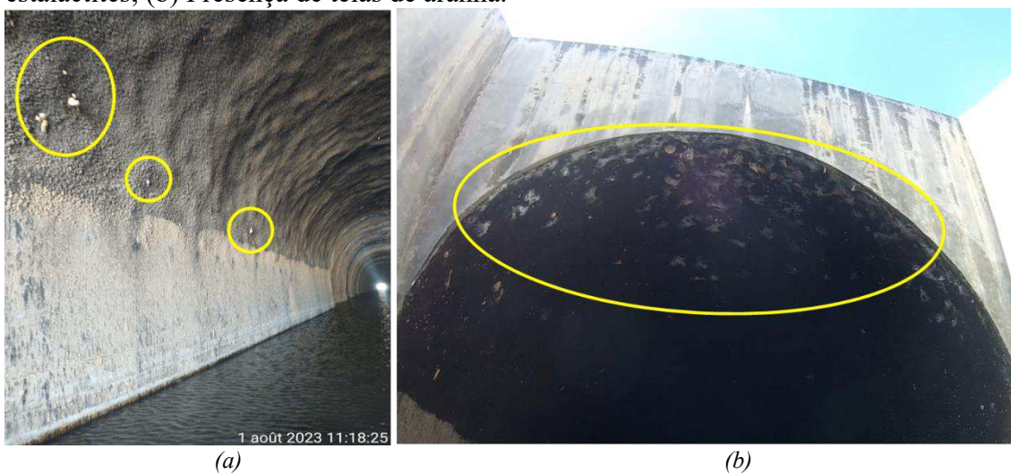
Figura 2.14 – Registros fotográficos realizados na inspeção: (a) Formação de estalactites; (b) Presença de teias de aranha.
