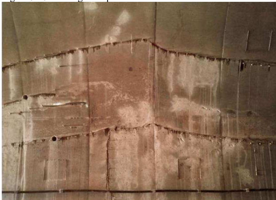
Figura 5.18 – Ferragem exposta em revestimento de concreto.
