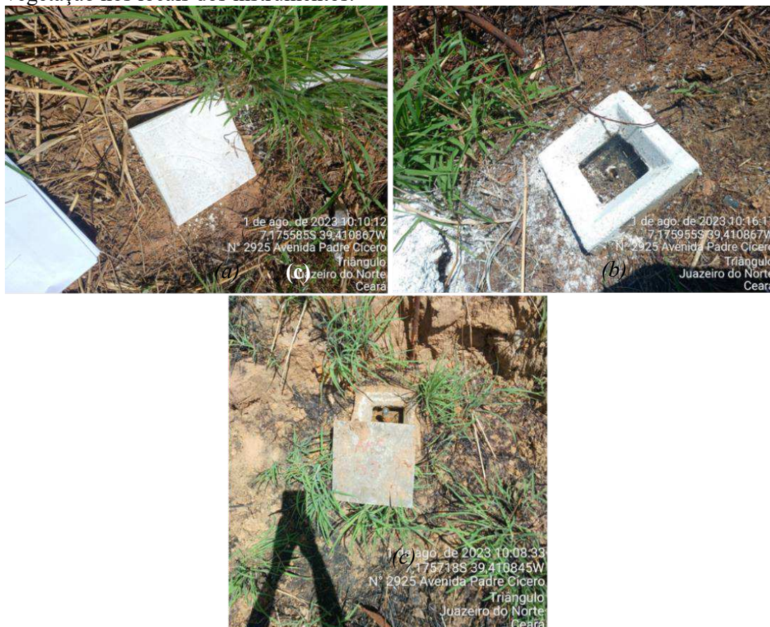
Figura 2.12 – Registros fotográficos realizados na inspeção: (a) Má conservação de placas de identificação; (b) Equipamento danificado e desprotegido; (c) Presença de vegetação nos locais dos instrumentos.
