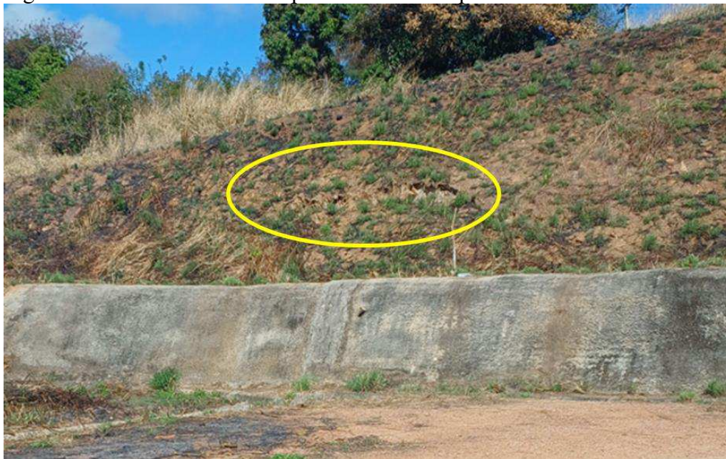
Figura 2.13 – Erosão no talude próximo ao emboque do túnel.
