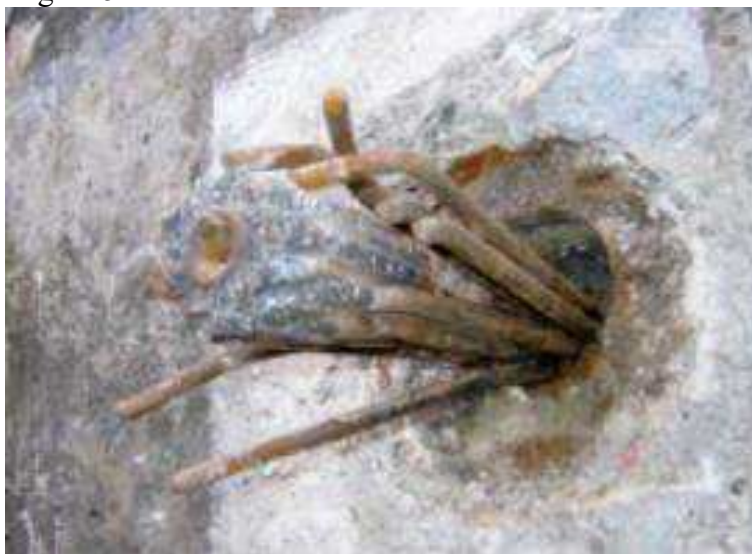
Figura 5.12 – Corrosão em tirante.
