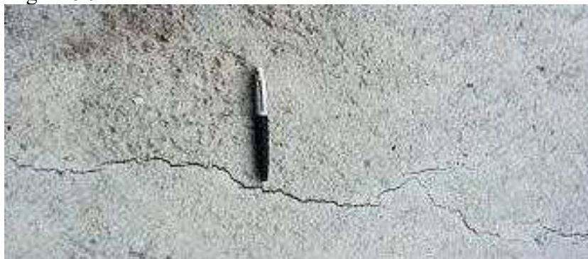
Figura 5.9 – Fissuramento no concreto.
