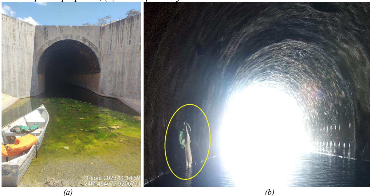
Figura 2.11 – Registros fotográficos realizados na inspeção: (a) Presença de macrófitas e coloração inapropriada; (b) Presença de objeto estranho.
