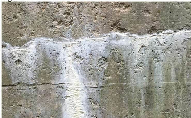
Figura 5.23 – Eflorescência no concreto.
