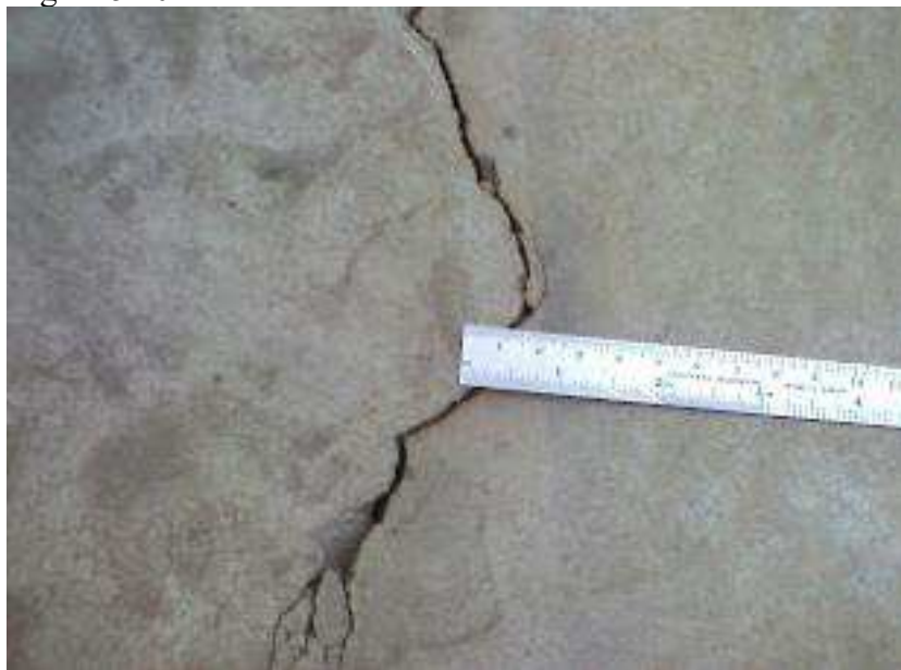
Figura 5.10 – Trinca no concreto.
