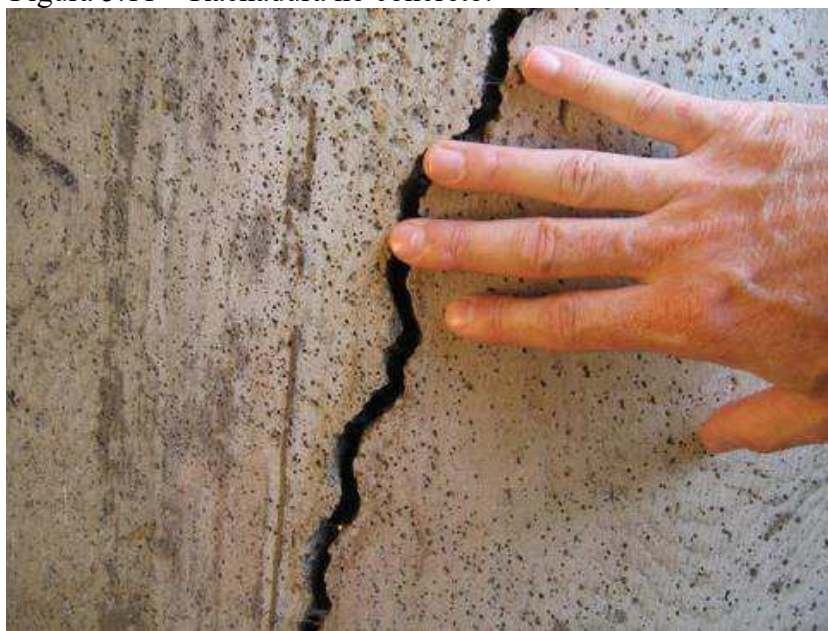
Figura 5.11 – Rachadura no concreto.
