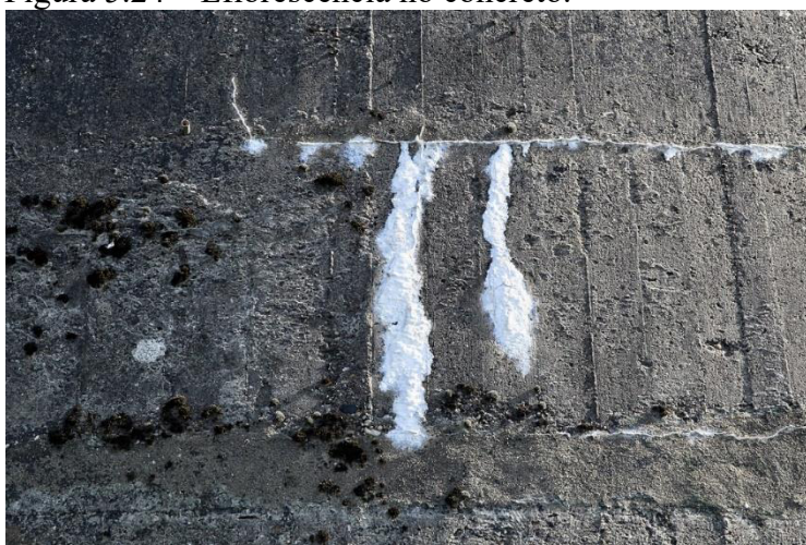
Figura 5.24 – Eflorescência no concreto.
