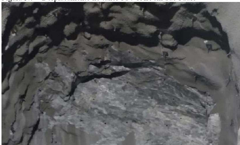
Figura 5.7 – Deslocamento no túnel TS4 CAR em São Paulo
