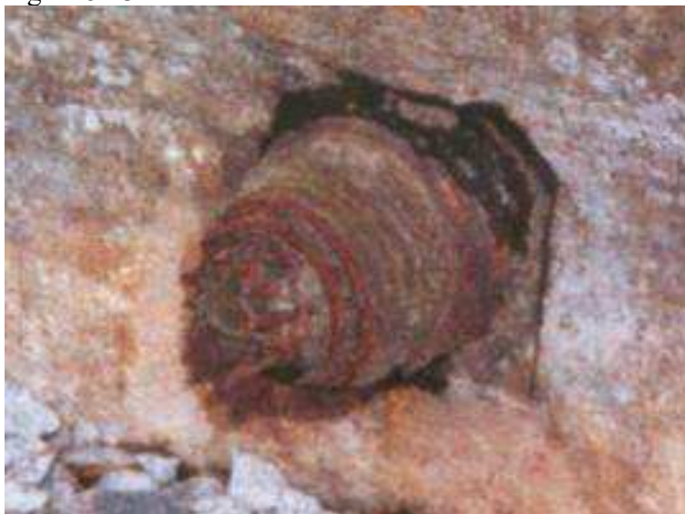
Figura 5.13 – Corrosão em tirante.
