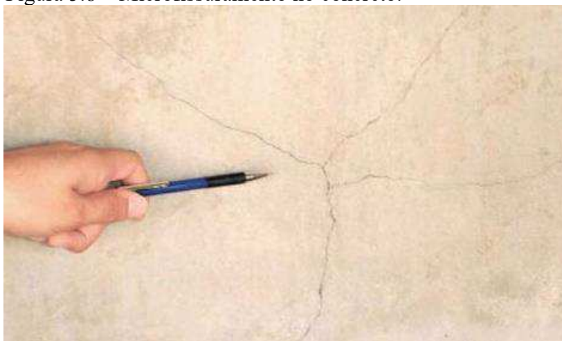
Figura 5.8 – Microfissuramento no concreto.
