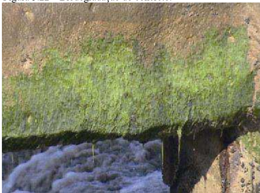
Figura 5.22 – Biodegradação do concreto.
