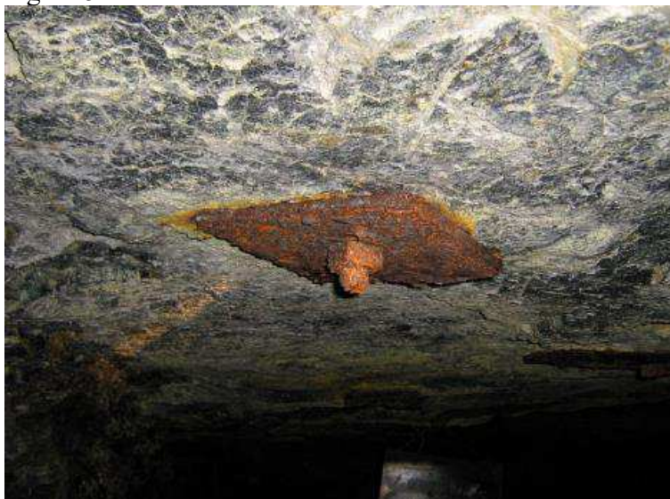
Figura 5.14 – Corrosão em chumbador.
