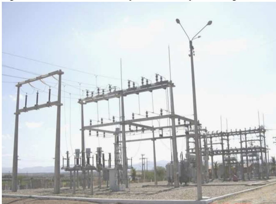
Figura 1 – Pátio de uma subestação de distribuição de energia.
