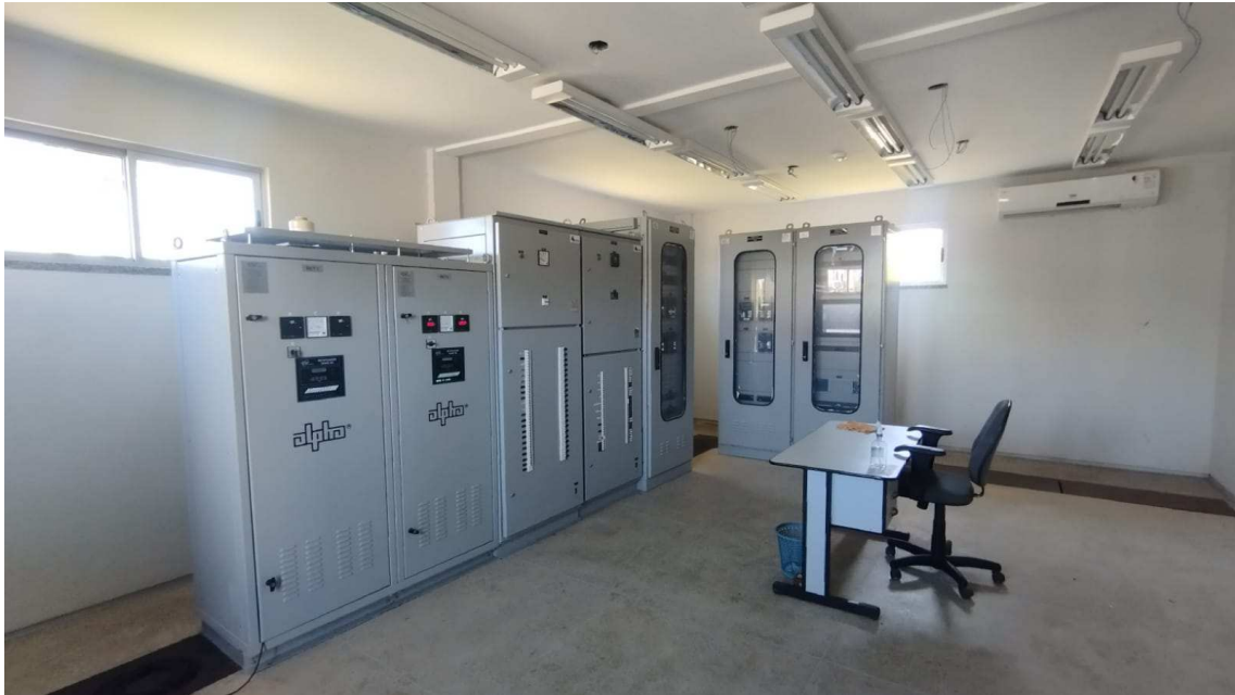
Figura 10 – Ambiente da Casa de Comando com os Quadros de Proteção e Automação.
