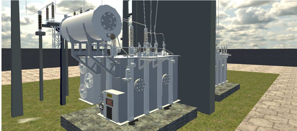
Figura 25 – Vão de transformação da subestação.
