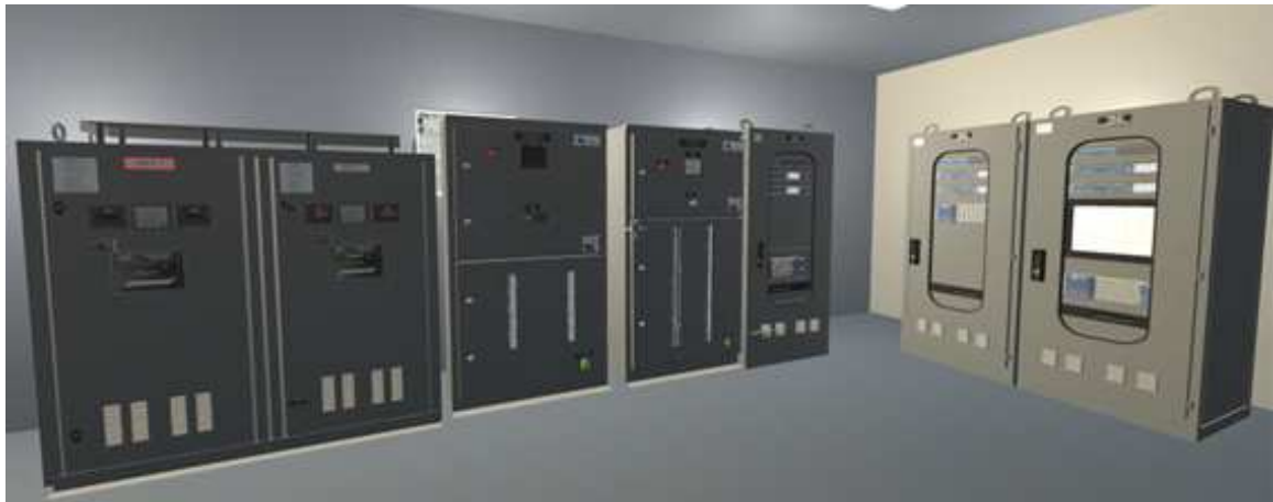
Figura 28 – Quadros da casa de comando.
