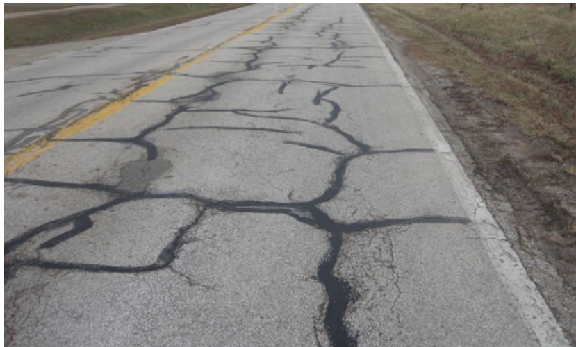
Figura 7 – Fissuras em forma de bloco
