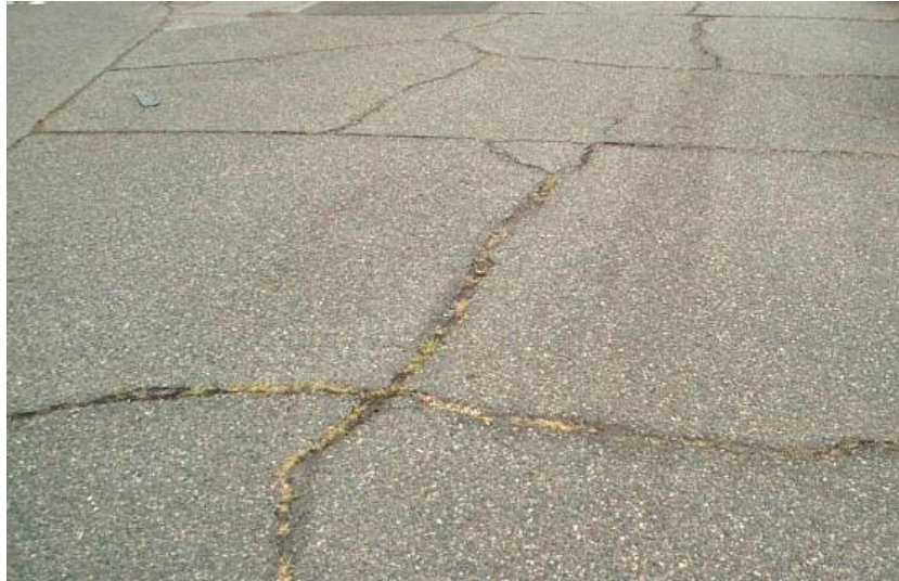
Figura 6 – Fissuras por Reflexão
