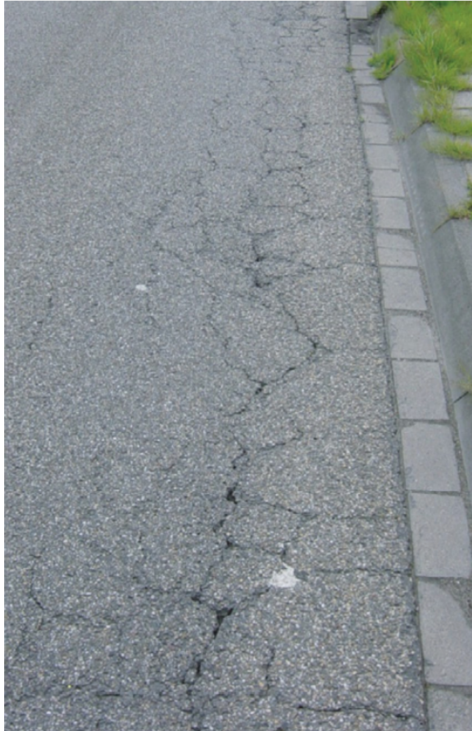
Figura 5 – Fissuras por Fadiga
