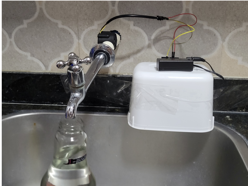
Figura 25 – Medido de água instalado
