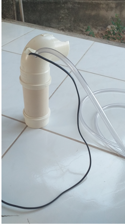
Figura 20 – Figura da bomba alocada no sistema de calhas 2.
