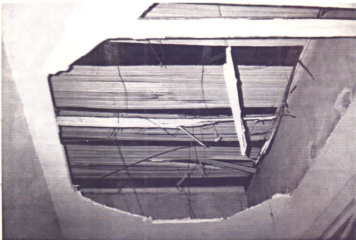
Foto 25 - Forro da REU da Av. da Universidade, 2142. O forro anterior, quebrado e destruído pelo cupim, foi "escondido" por um novo, de gesso. Este é um exemplo do tipo de manutenção feita nas REUs pela UFC.
