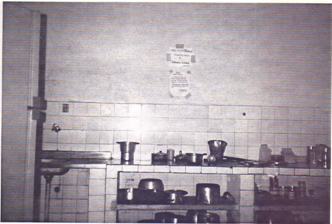
Foto 19 - Bancada da cozinha da REU da Av. da Universidade, 2142. Falta de local adequado para guardar utensílios domésticos.
