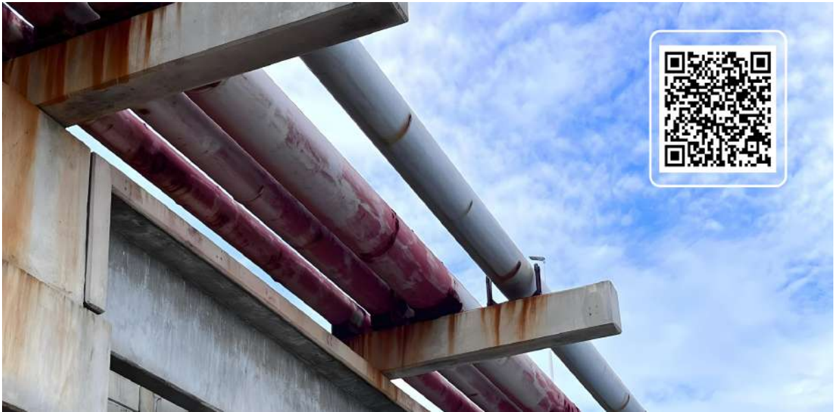
Figura 62 – Tubulações no Porto do Pecém e um QR Code contendo diversas imagens das estruturas do CIPP.
