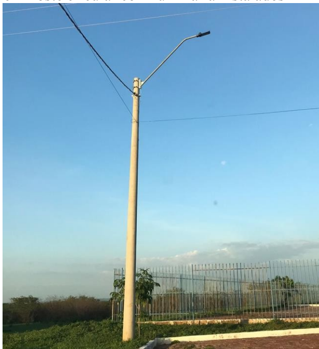
Figura 29 - Poste circular com luminária instalados
