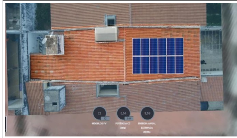
Figura 49 – Posição dos painéis via SolarEdge (Microinversor).
