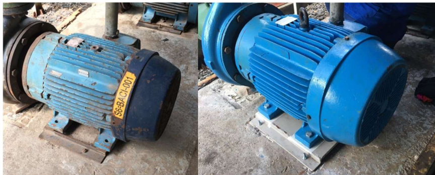
Figura 42 - Equipamento antes e após manutenção na sua estrutura de fixação.
