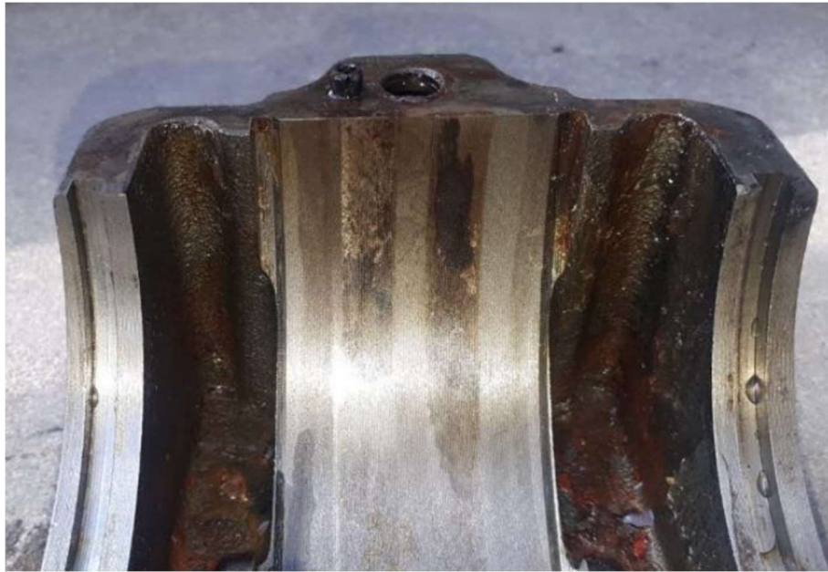
Figura 33 - Desgastes do mancal próximo a polia do exaustor em estudo.
