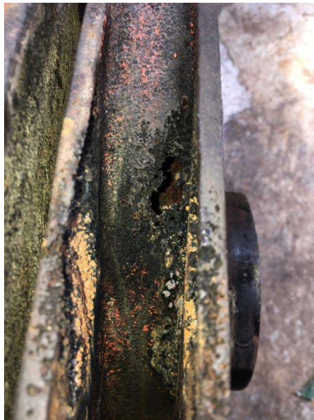
Figura 36 - Desgaste no rotor da bomba centrifuga.
