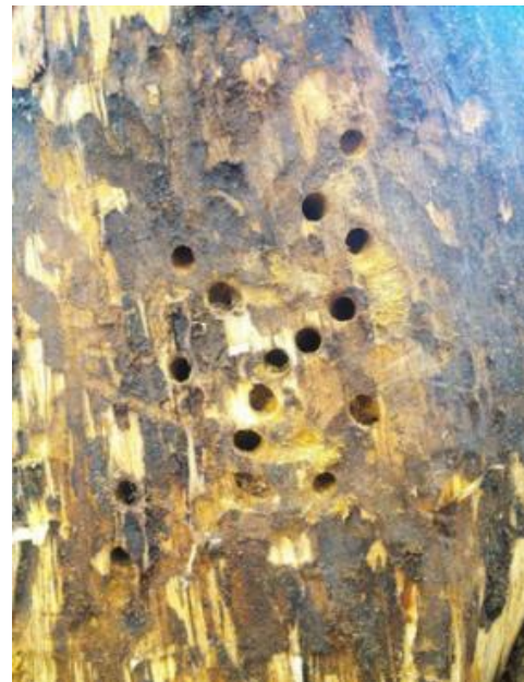
Figura 15 - “Furo de bala” dano típico do ataque da broca
