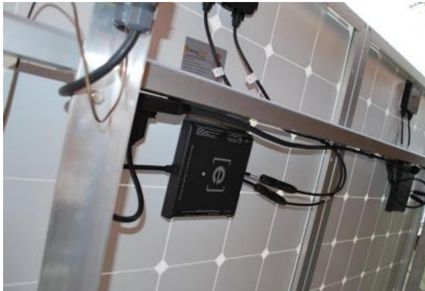
Figura 10 – Microinversores instalados nas costas dos módulos fotovoltaicos
