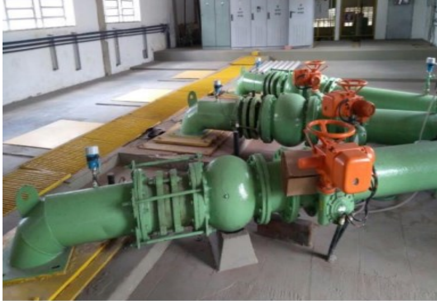
Figura 13 – Grupo de Bombas da EEA Aldeota
