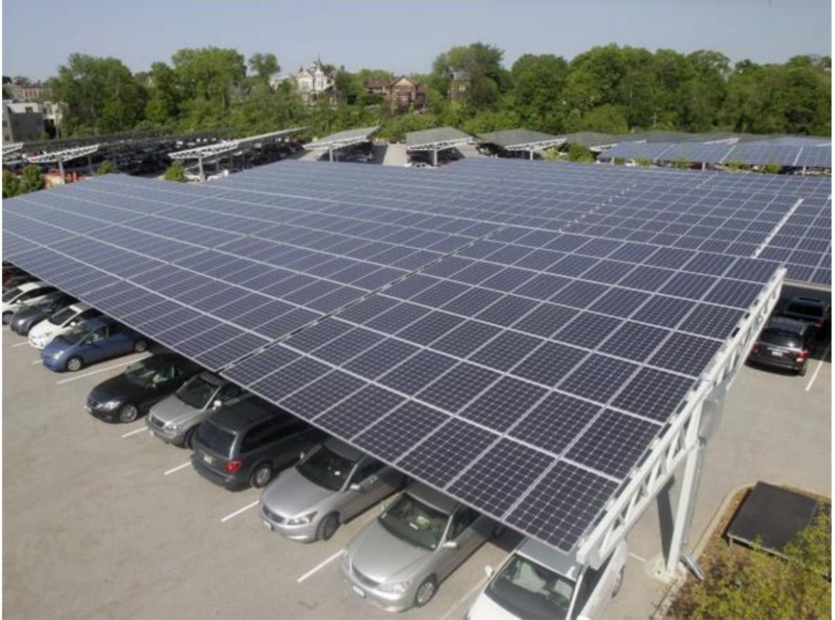
Figura 2 - Estacionamento com módulos fotovoltaicos na UFRJ.
