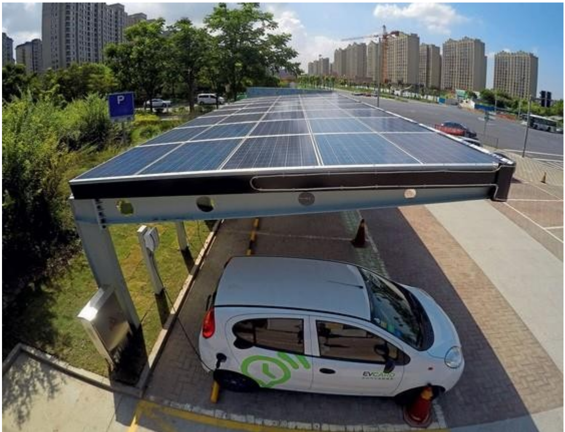
Figura 14 - Carro elétrico sendo carregado pela energia fotovoltaica.
