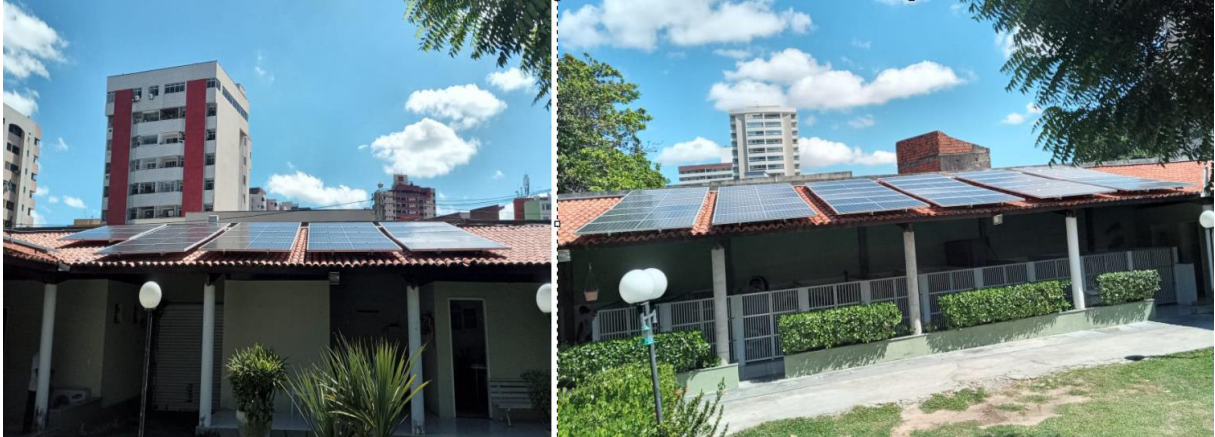
Figura 7 - Módulos instalados no sistema 1
