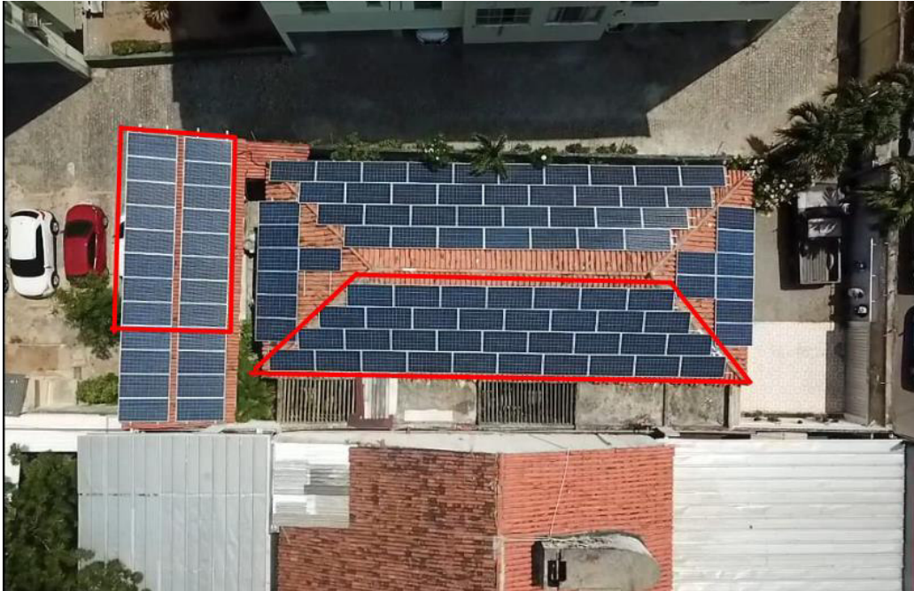
Figura 9 - Módulos instalados no local, sendo os utilizados para a simulação apenas os que estão circulos.
