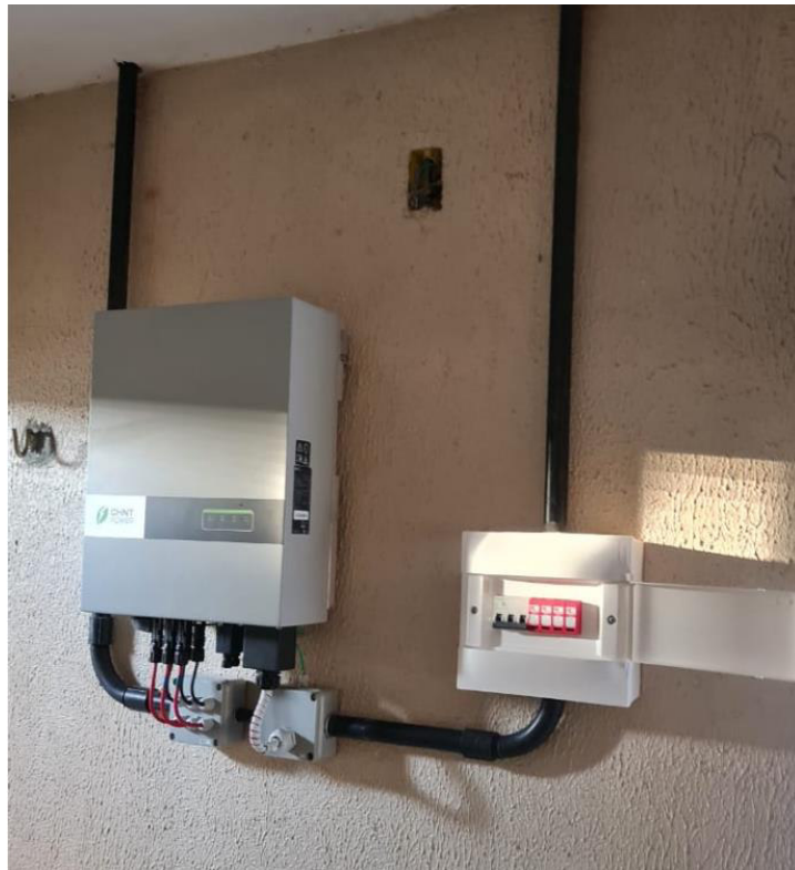
Figura 8 - Inversor instalado no sistema 2.
