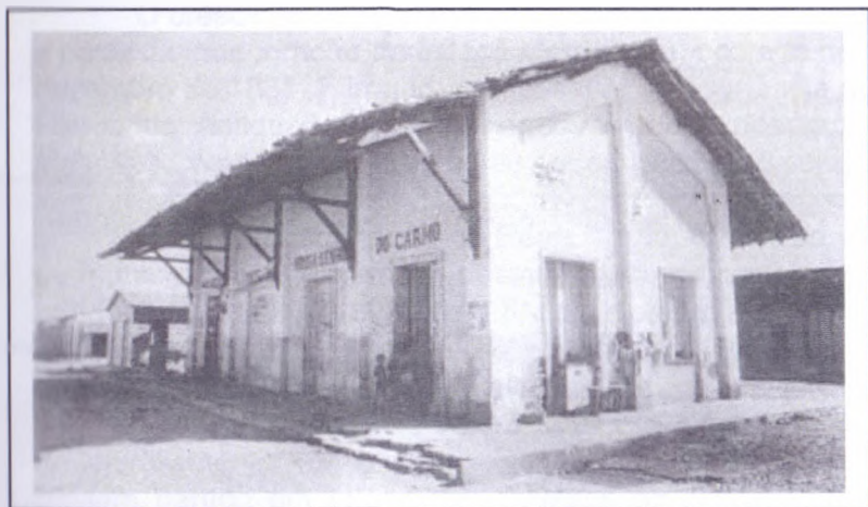
Foto 3.5.4: Estação Ferroviária de Senador Sá, inaugurada no dia 2 de julho de 1881; encontra-se em péssimas condições de conservação.
