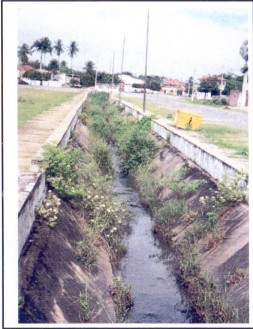
Foto 5.2: Detalhe do Canal, à Rua Senador Virgílio Távora, onde podemos observar em que condições de saneamento o canal se encontra, atualmente.
