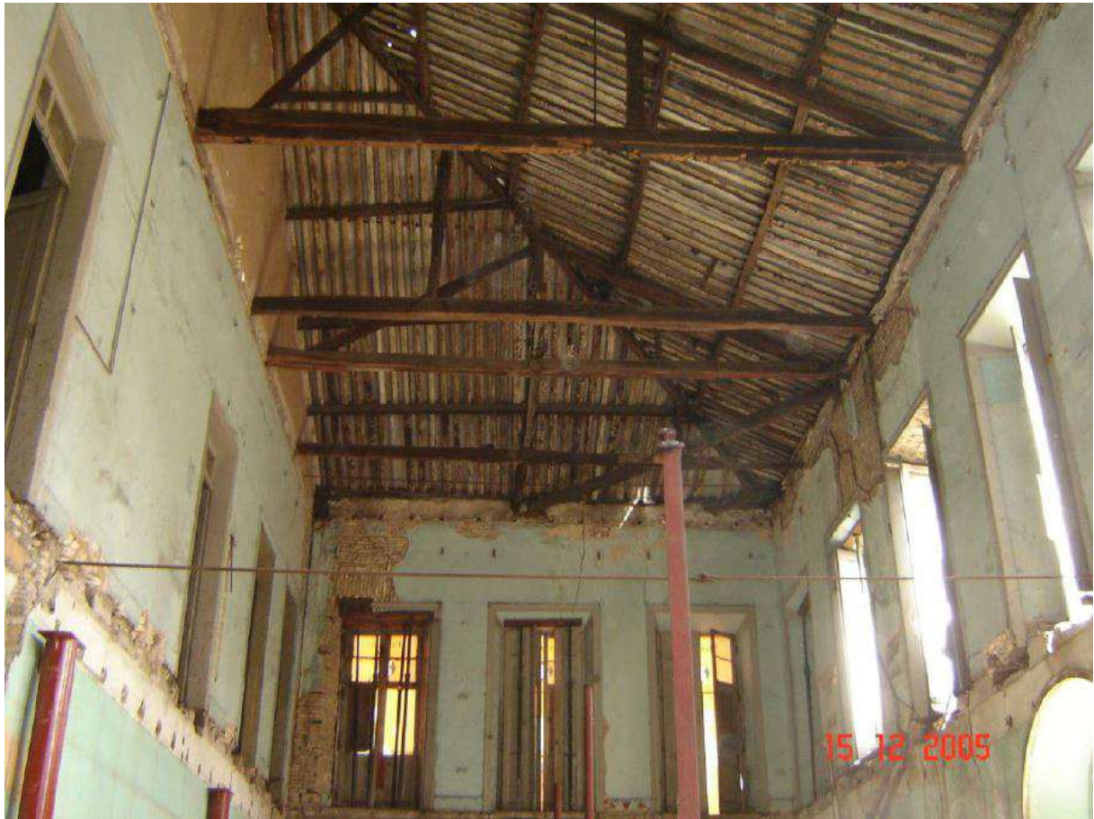
Figura 172.b. Durante o restauro em 2005. Deterioração geral e ausência do piso superior. Fonte: Acervo pessoal do arquiteto Domingos Linheiro.
