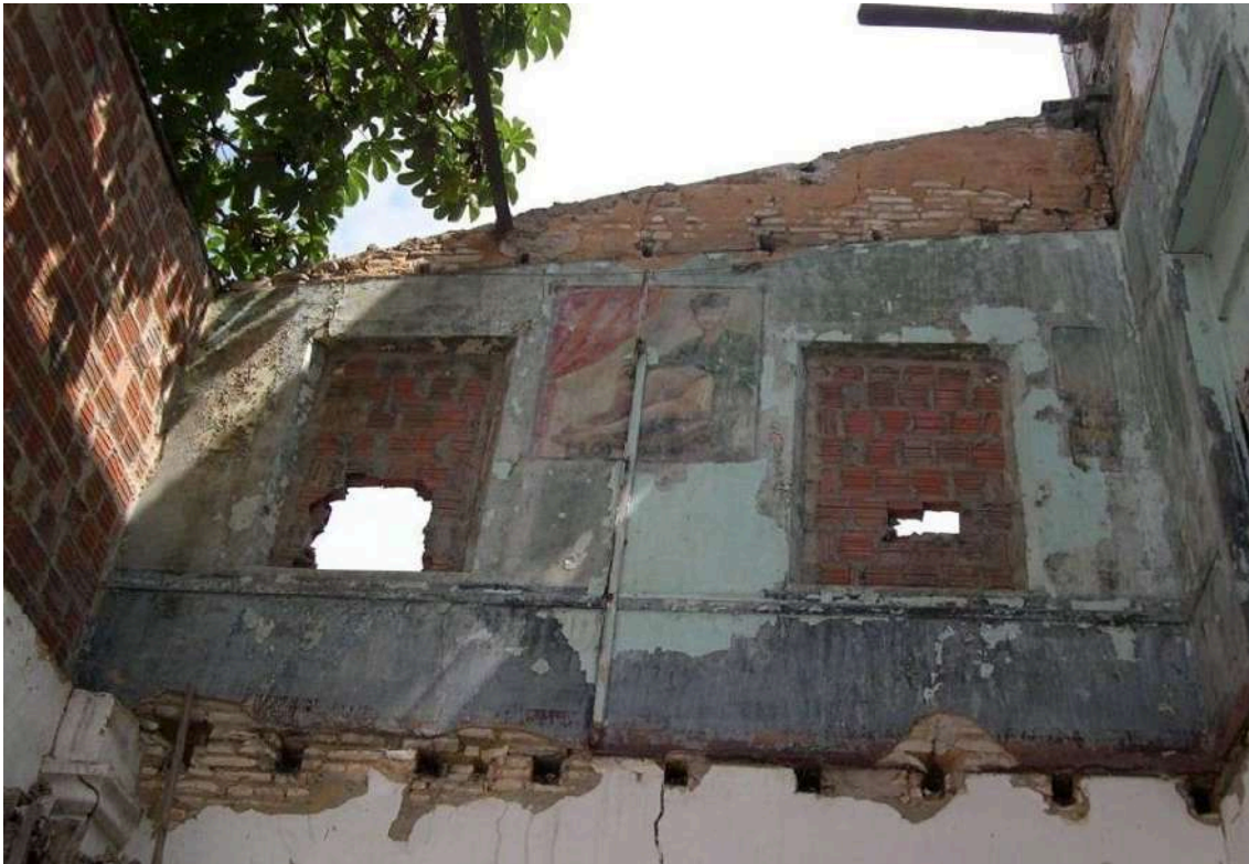
Figura 143. Espaço ainda degradado onde hoje está a biblioteca do sobrado. Entre as janelas, a pintura na parede uma mulher. Fonte: acervo pessoal do arquiteto Domingos Linheiro.
