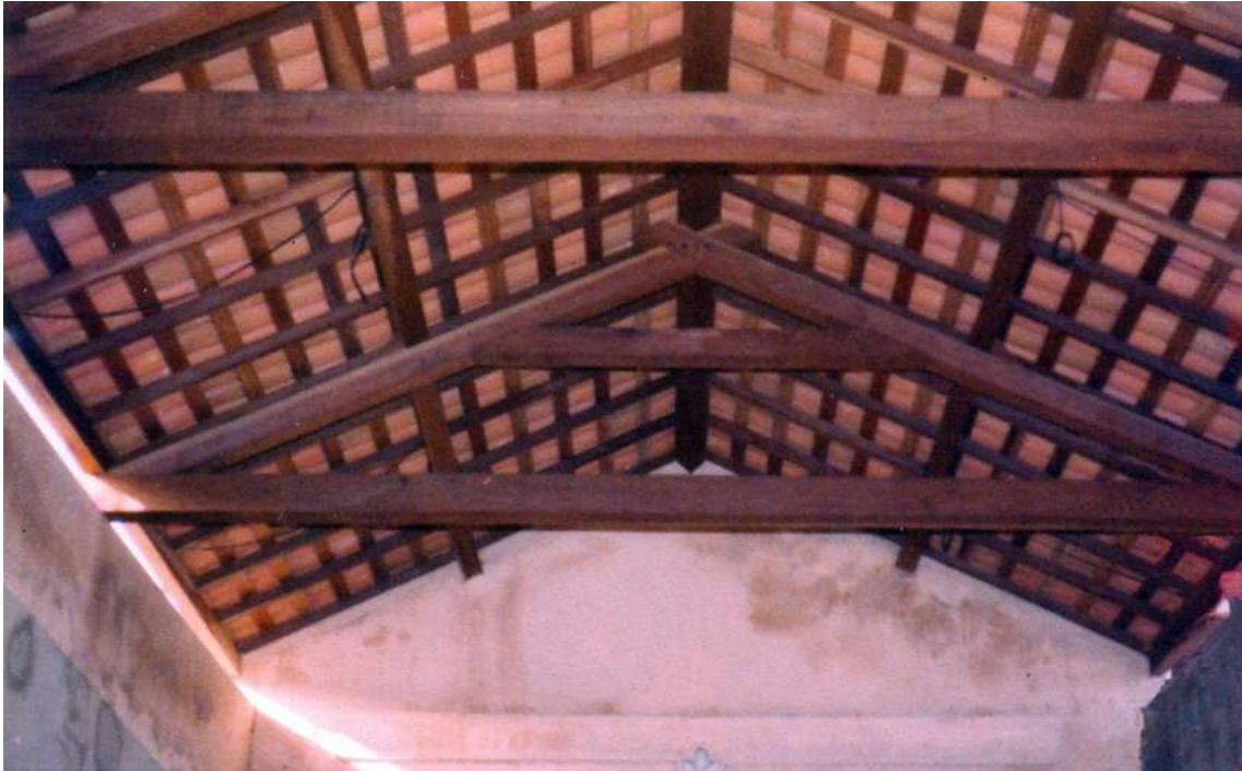
Figura 114. Igreja de Nossa Senhora da Conceição de Almofala,CE. Novas tesouras de madeira após o restauro de 1983. FONTE: acervo pessoal do arquiteto Domingos Linheiro.
