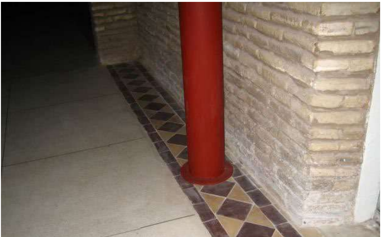
Figura 184. Detalhe do piso industrial e a “moldura” feita com o piso remanescente do século XIX. Ao lado, a coluna metálica e a parede sem reboco, expondo a técnica construtiva dos seus tijolos delgados. Fonte: acervo pessoal do arquiteto Domingos Linheiro.
