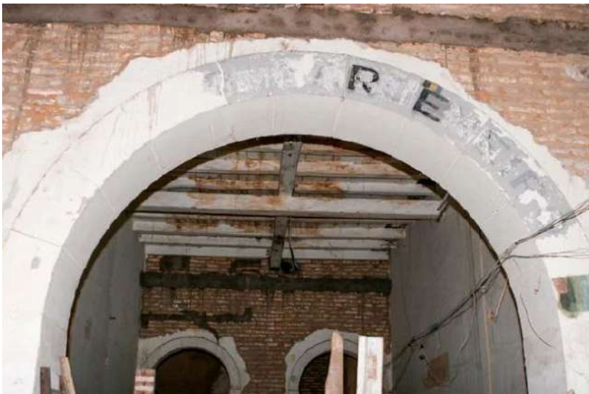
Figura 146. Ausência de manutenção. Arco de porta e estrutura do piso. Fonte: acervo pessoal do arquiteto Domingos Linheiro.
