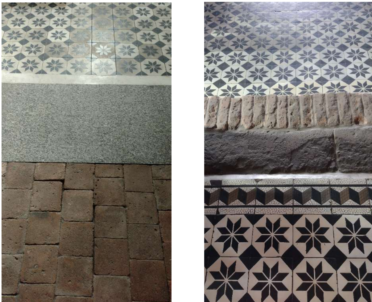
Figura 134. Igreja Matriz de Viçosa. Destaque para a transição dos pisos entre a soleira. De um lado o ladrilho hidráulico e do outro o piso de tijoleira. Fonte: acervo pessoal de Beatriz Chaves, 2022.
