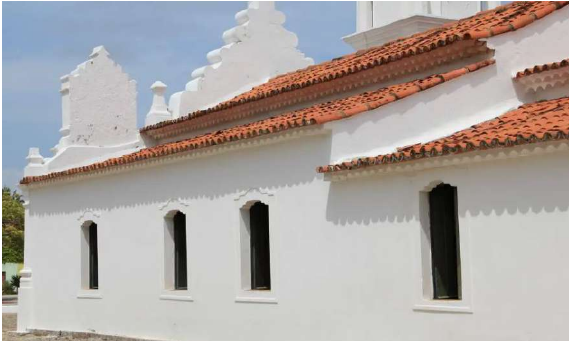
Figura 107. Igreja de Nossa Senhora da Conceição de Almofala, CE. Fachada lateral da igreja e telha em disposição beira-seveira no beiral. Fonte: Superintendência do IPHAN -CE.
