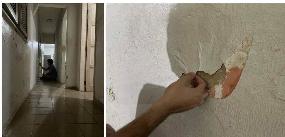
Figura 31 - Processo de retirada dos rebocos das paredes da casa da Dona Zilda.
