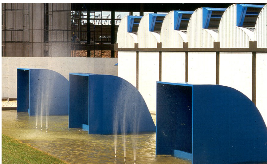
Figura 80 – Tomadas de ar com sistema de pulverização de água
