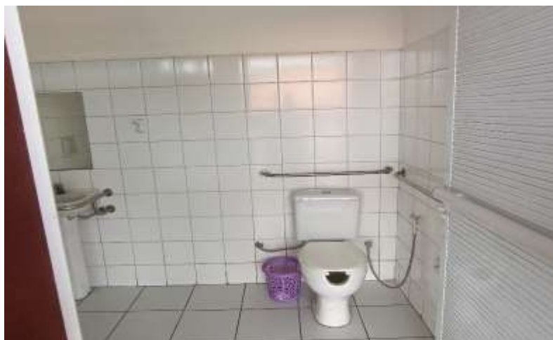
Figura 8 - Banheiro adaptado: vaso sanitário.
