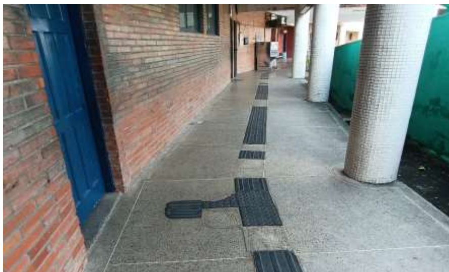
Figura 6 - Corredor inferior, com destaque para o piso podotátil desgastado.
