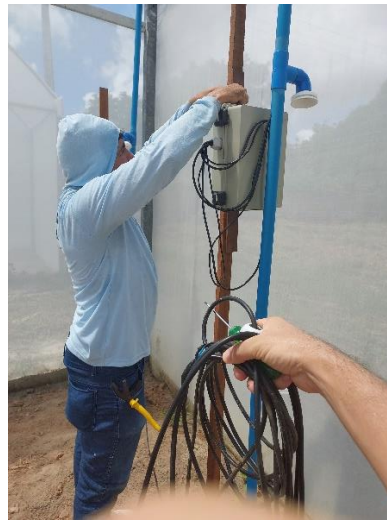
Figura 24: Instalações das Estações de Coletas (Estufa 1) e fixação dos cabos de alimentação dos sensores
