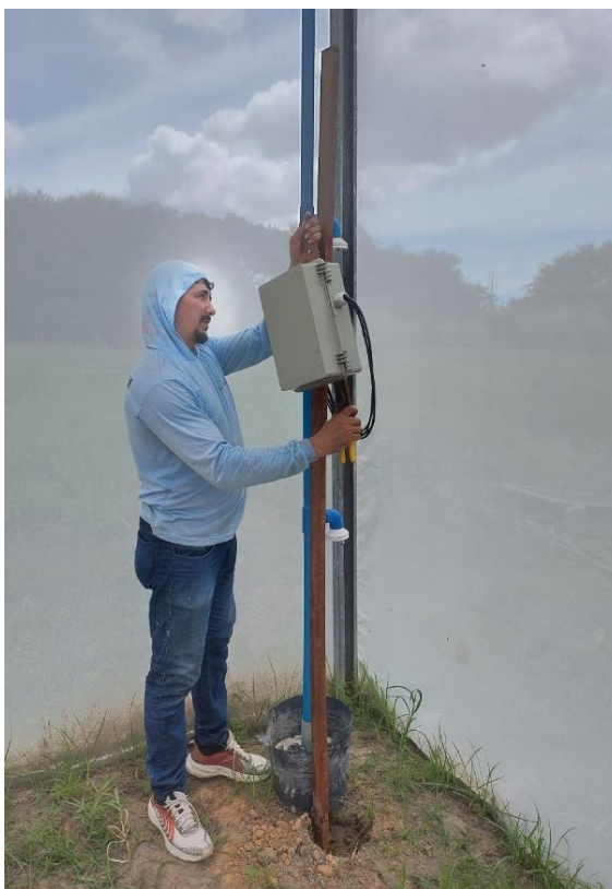
Figura 20: Fixação das caixas de proteção com os componentes eletrônicos em cada Estação de coletas
