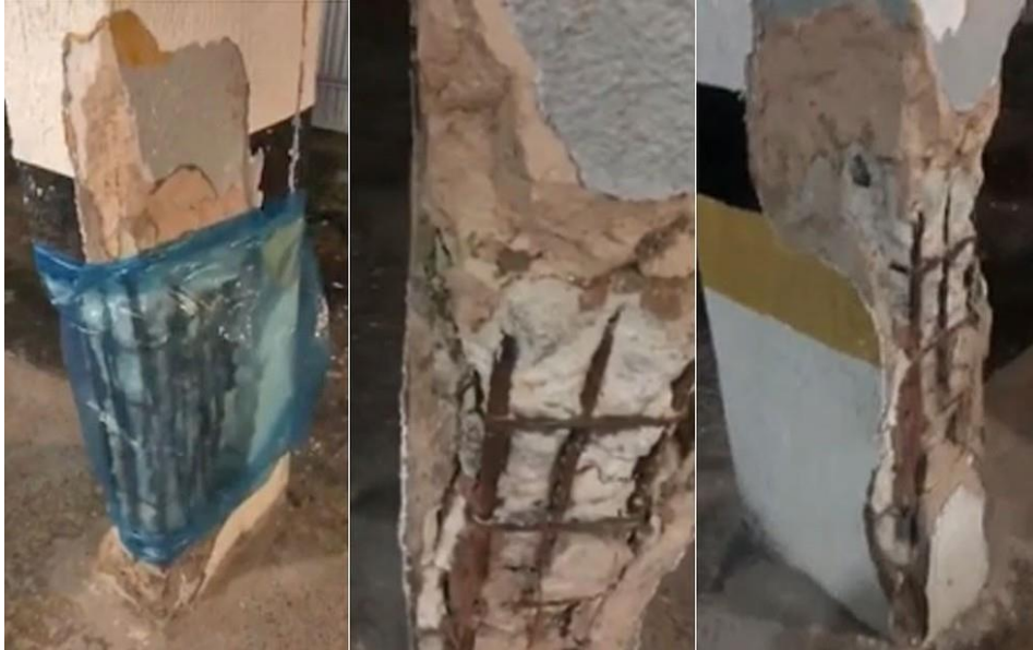
Figura 3 - Condição dos pilares antes do desabamento – Ed. Andrea
