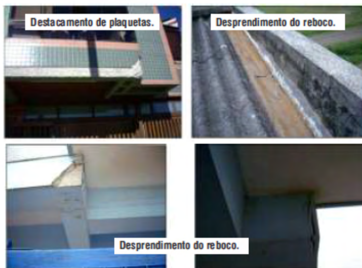
Figura 5 - Exemplos de destacamento de revestimento
