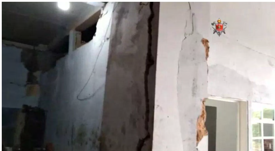
Figura 1 - Estrutura de prédio que desabou em Taguatinga, no DF.
