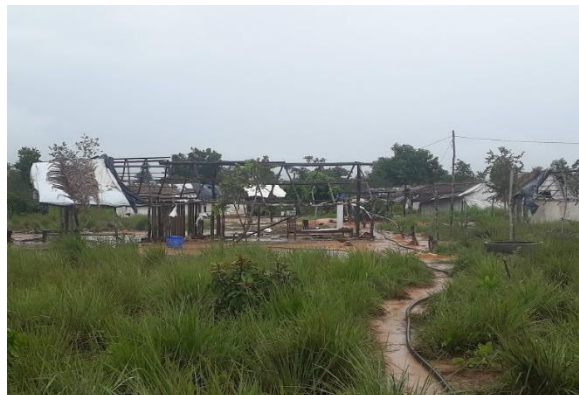
Figura 43 – Barraco do Acampamento após uma forte chuva
