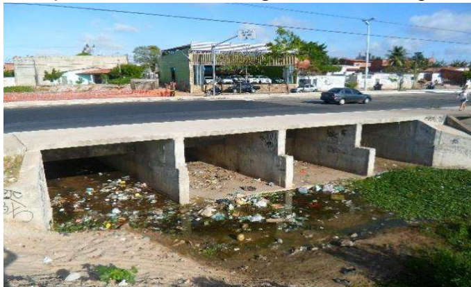
Figura 3 – Obstruções das redes de drenagem de Fortaleza por resíduo sólido
