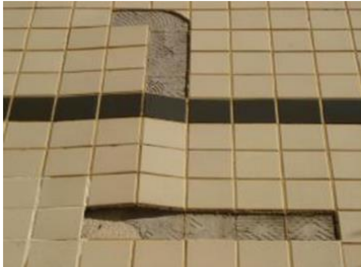
Figura 4 – Deslocamento de revestimento cerâmico
