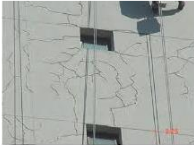
Figura 9 – Fissuras em revestimento argamassado
