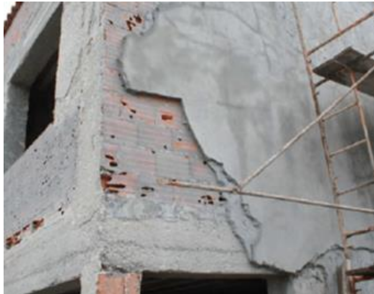
Figura 5 – Deslocamento de revestimento argamassado
