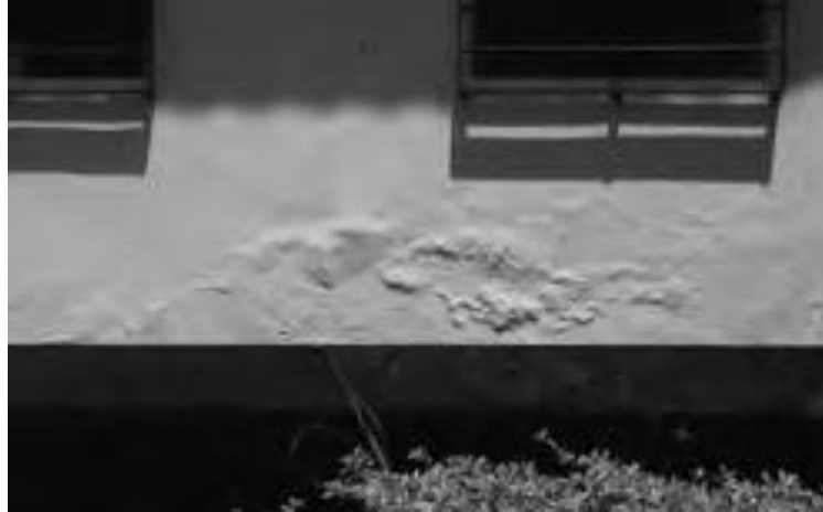
Figura 7 – Empolamento de revestimento argamassado
