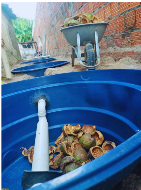
Figura 22 - Tubulação perfurada para passagem do esgoto no filtro anaeróbio.
