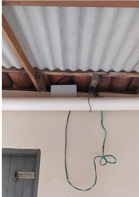
Figura 39 – Dispositivo concentra- dor instalado.
