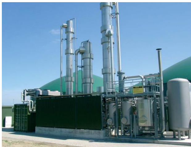
Figura 7: Estação de tratamento de biogás por lavagem Genosorb .
