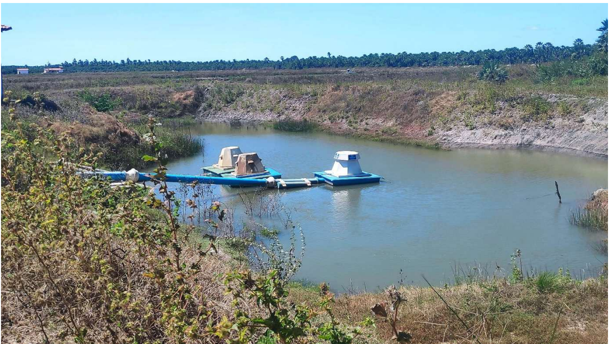
Figura 2 - Sistema de captação de água.
