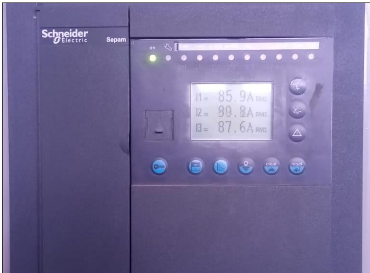
Figura 39 – Relé Sepam 1000 com leitura de corrente do respectivo motor
