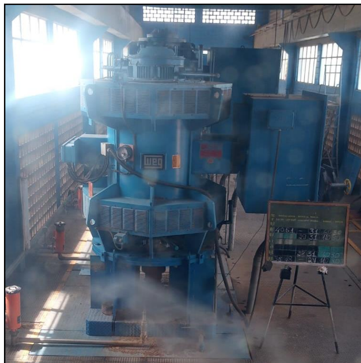
Figura 38 – Bomba de recalque 163104 da WEG
